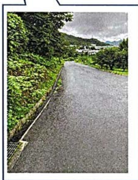
蓋のない用水路
