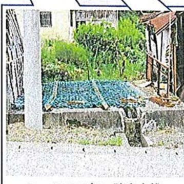
フェンスの無い防火水槽
