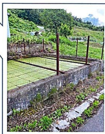
蓋のない防火水槽
