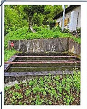
● 蓋のない防火水槽
