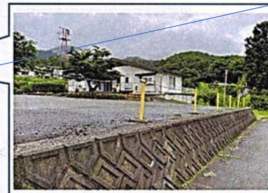
駐車場の道路との段
