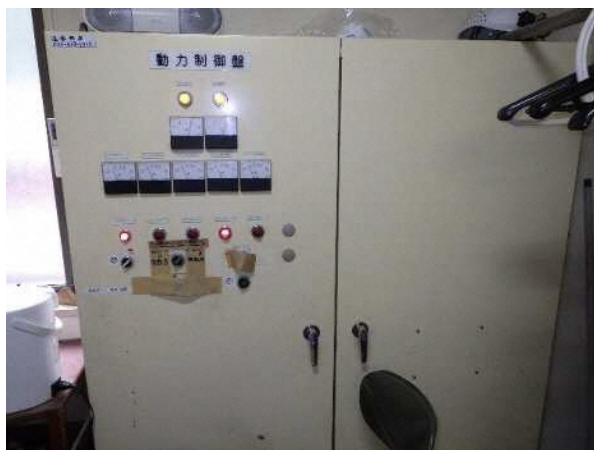
写真 23. 動力制御盤（監視室内）
