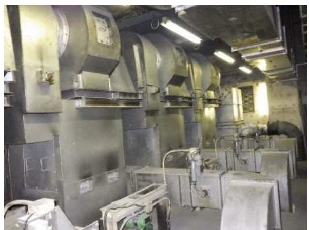
写真 20. 火葬炉排煙設備 (1～5 号機)
