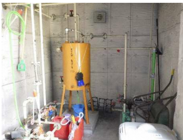
写真 25. オイルサービスタンク（機械室内）
