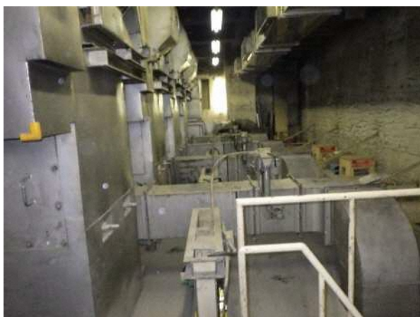
写真 19. 火葬炉排煙設備 (1～5 号機)
