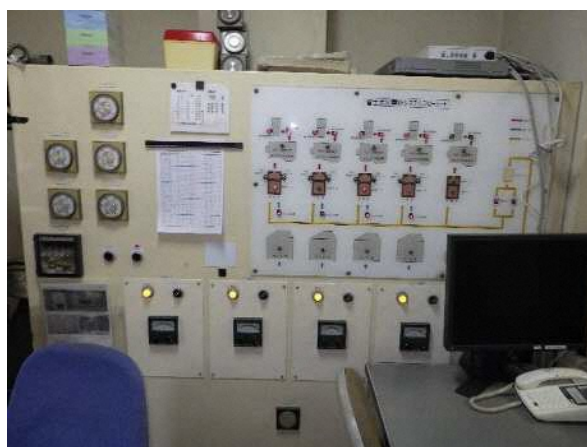
写真 22. 火葬システム（監視室内）
