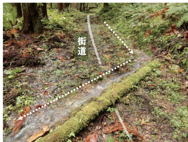
図 207 街道を横断する排水溝
