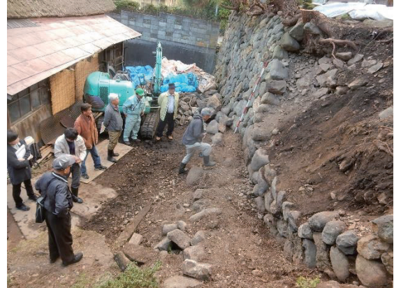
図 154 災害復旧検討委員会による現査
