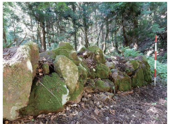
図 165 崩落した石積み（馬頭塔付近）
