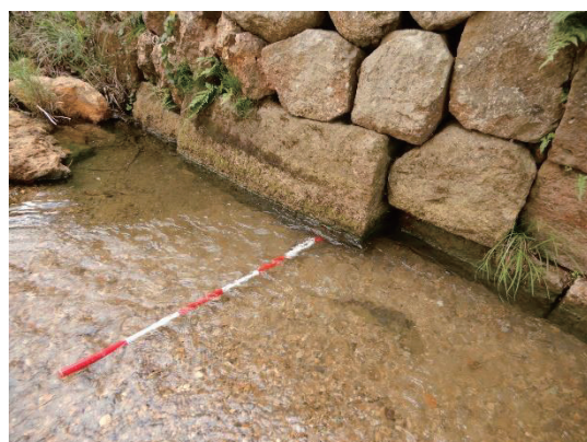
図 144 水衝部で洗掘され切石の下が 80cm 空洞化
