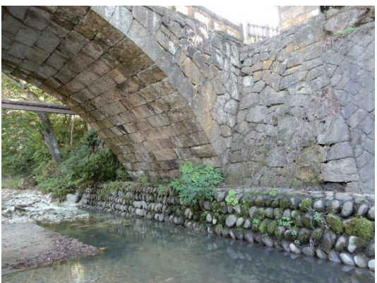
図 147 新橋の水衝部の河床洗掘対策
