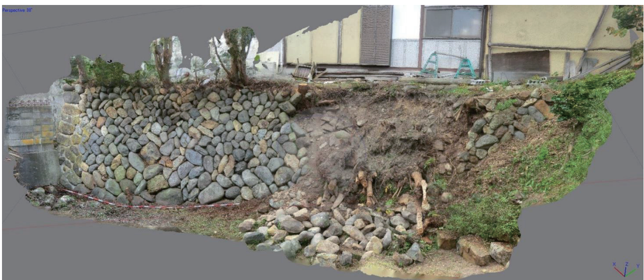
図 150 史跡「橋本屋」西側の石垣崩落状況（阿子島功委員による写真合成）
