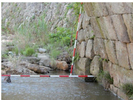
図 143 アーチ部と橋台とのズレ
