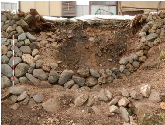
図 153 倒伏スギ、崩落石垣等を撤去
