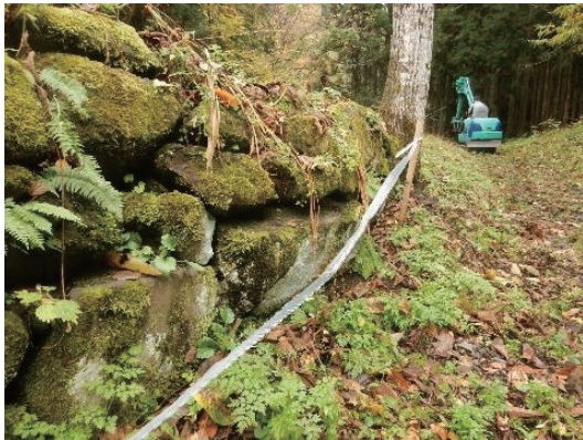
図 164 はら 孕んだ石積み（金山宿頭付近）。近隣の樹木の根による影響と推定される
