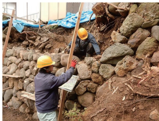
図90 崩落した石垣の復旧（H30）2018
