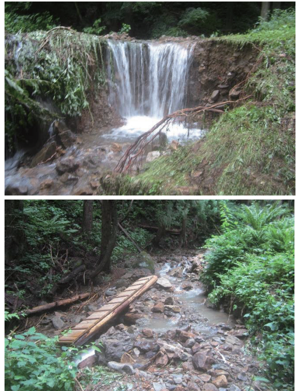
図1 豪雨に伴い発生した土石流で金山越の羽州街道23箇所が被災。平成26年（2014）7月9日～10日
