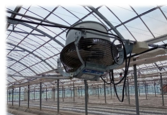
ハウスに設置された循環扇
