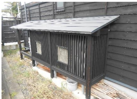
木製格子で囲った室外機
