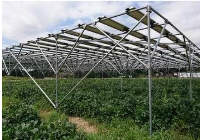
■田畑の上部にパネルを設置した例
