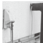
▲凍結防止ヒーターのコンセント
