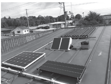
太陽熱温水器や太陽光発電装置のパネルの設置例
