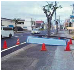
▲点検を行わず放置したことによる倒壊事故
