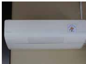
②-2 エアコン
