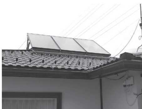
太陽熱給湯システムの集熱パネル
