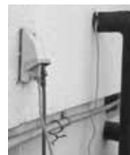
▲凍結防止ヒーターのコンセント
