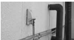
▲凍結防止ヒーターのコンセント
